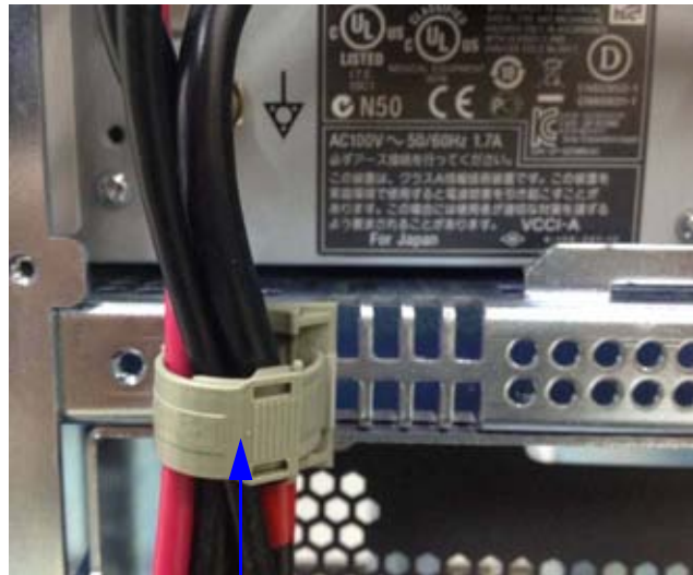
Left side cable clamp
